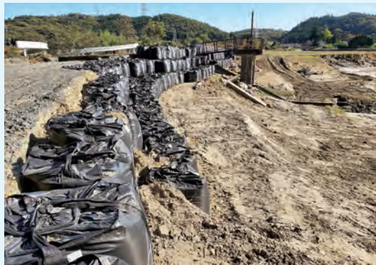
台風19号による破堤箇所(福島県いわき市鮫川沿岸)
